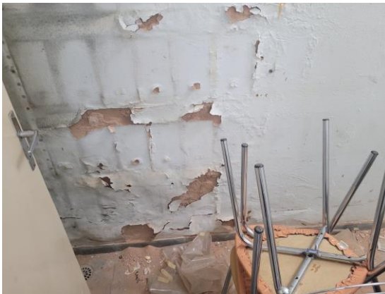
FOTO 11 – PAREDE PARA RESTAURAR
